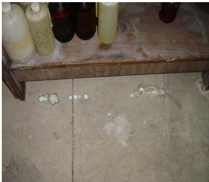
Foto 2. Evidencia de contaminación por nieblas y vapores ácidos
